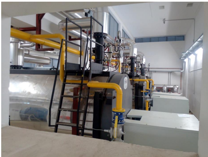
La nuova centrale termica – vista interna
