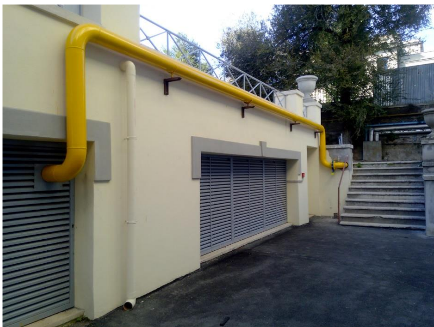
La nuova centrale termica – vista esterna
